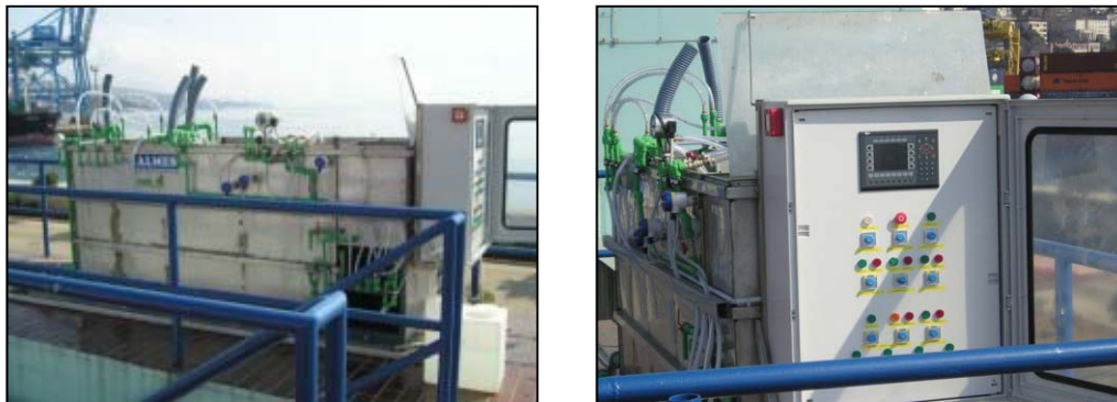
Slika 1. Pilot uređaj, MBR 15 ES, izgrađeno 2004.
