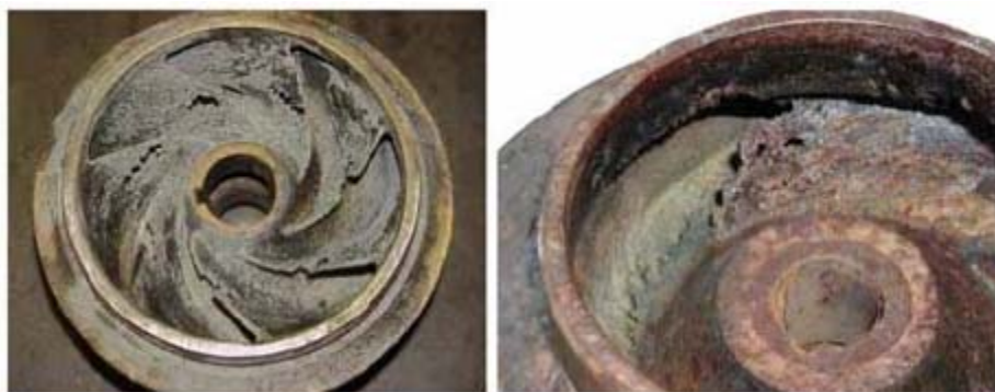
Slika 10. Tipična kavitacijska oštećenja rotora centrifugalnih crpki
