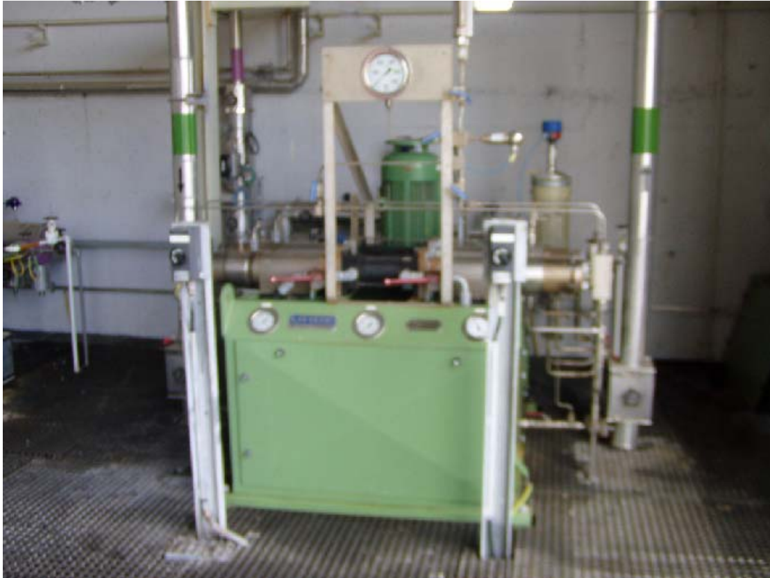
Slika 3: Visokotlačna hidraulička crpka
