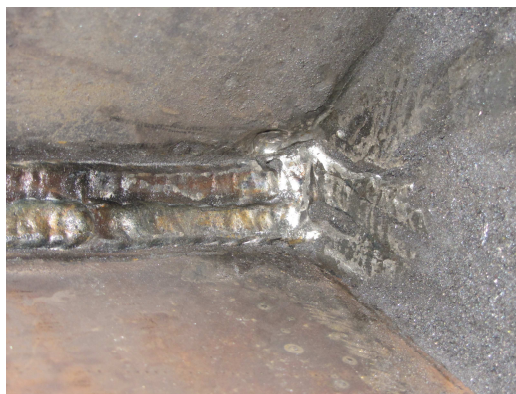
Greška otkrivena vizuelnom kontrolom
