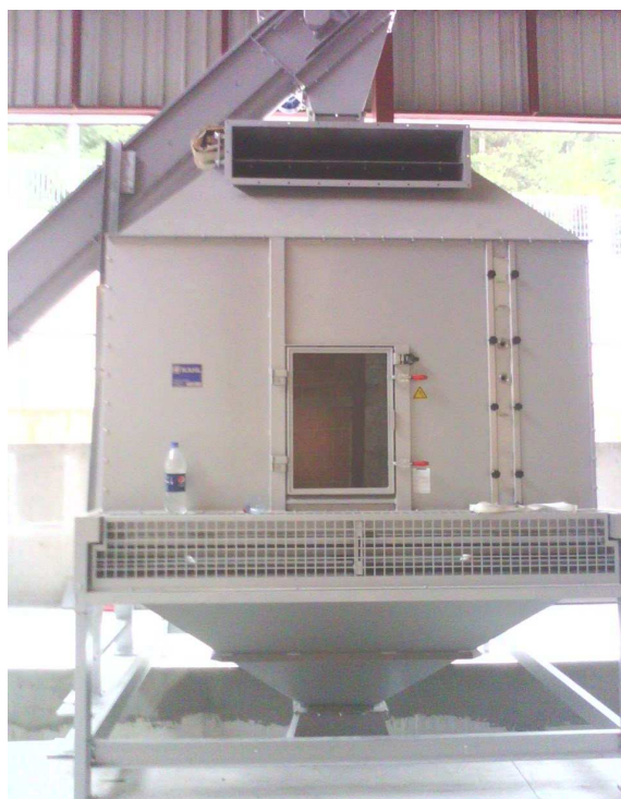
Sl. 21. Montirano postrojenje za hlađenje i otprašivanje peleta
