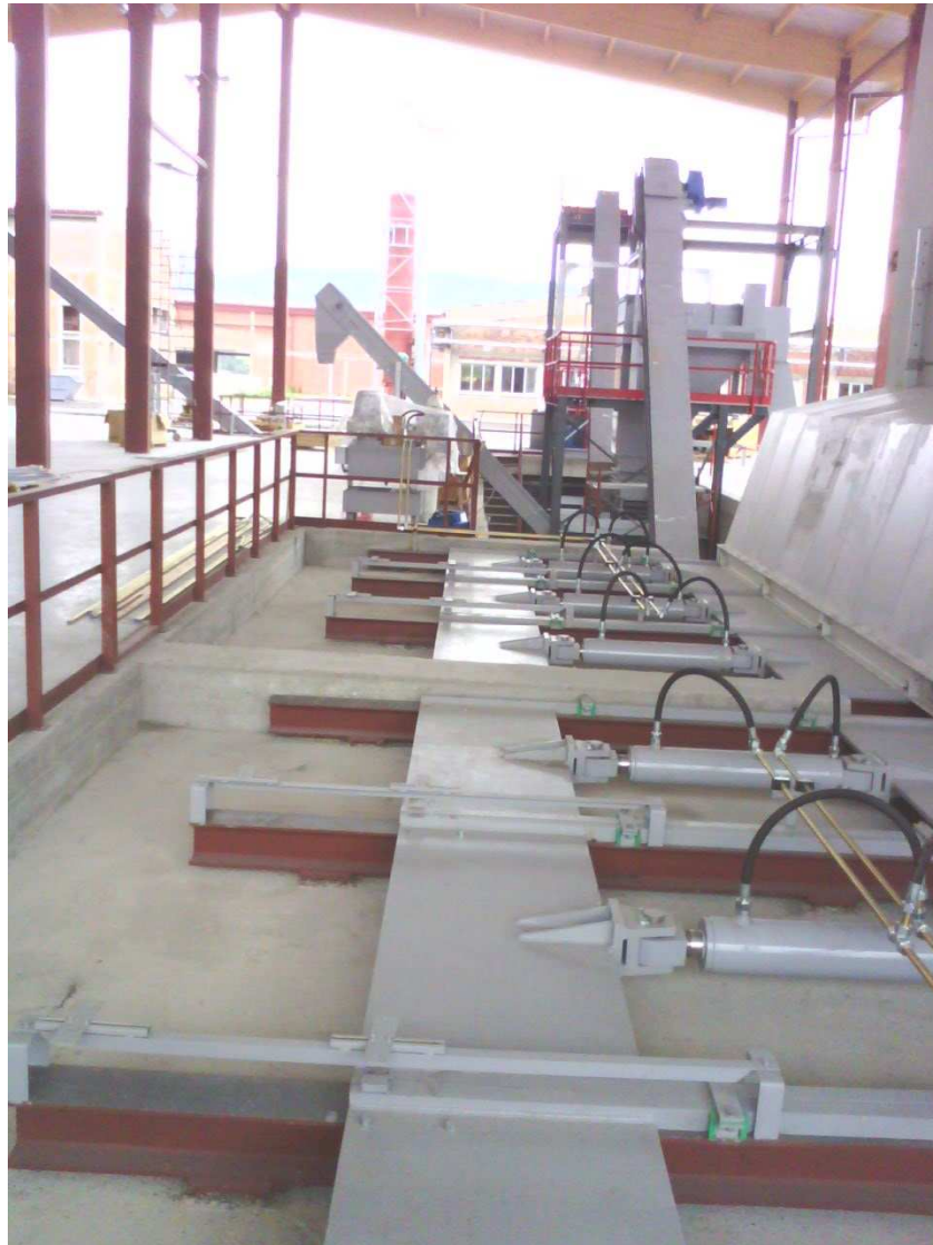
Sl. 2. Hidraulika za pokretanje podnih površina bunkera
