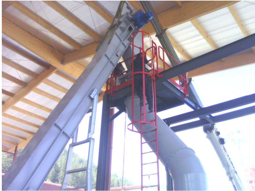
Sl. 49. Montirani elementi transportera sirovog iverja sa prijemnim silosom od mlina sirovog materijala do sušare
