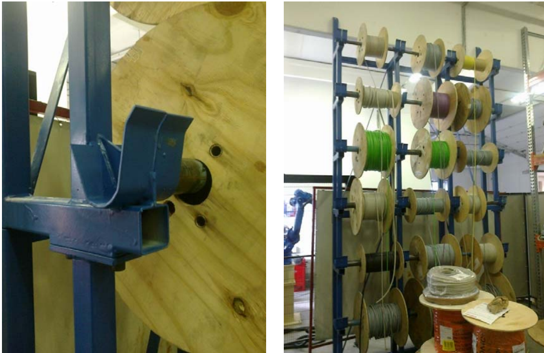
Slika 23. – Slika montiranog regala za kablove u skladištu elektro materijala
